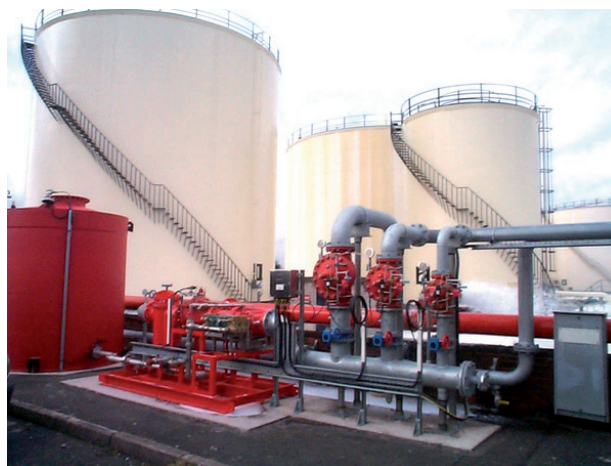
Instalação com Sistema de Proporcionalamento FireDos
